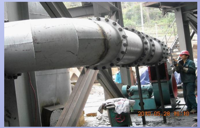
烧结余热电站补燃系统
